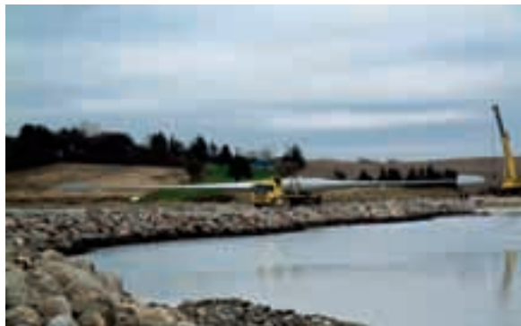
6 Üblicherweise werden bei der N60 die Flügel einzeln an die Nabe montiert. In Ebeltoft entschied sich Nordex für eine Sternmontage: An Land wurden die Flügel samt Nabe montiert und anschließend auf dem schmalen Weg des Piers zur entsprechenden Anlage befördert.
